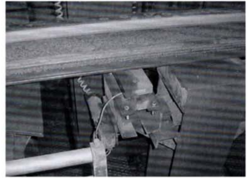
Zur Längenbestimmung (Schienenende) der auf Rollbahnen laufenden Schienen werden so genannte Flächenschalter eingesetzt, die die Schienen über die gesamte Rollenbreite erfassen können.
